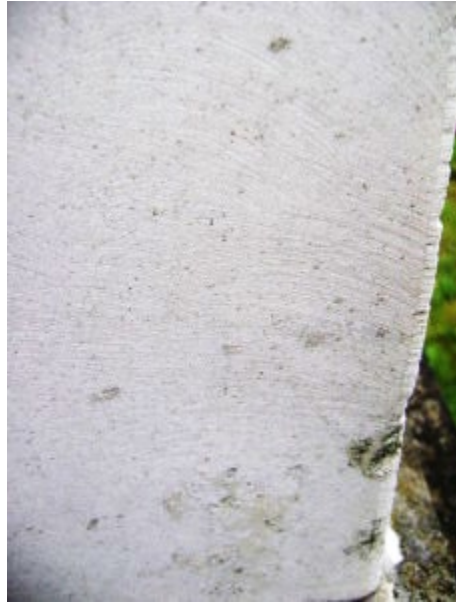
De Cerca del obelisco limpio, se pueden ver serias alteraciones de la superficie
