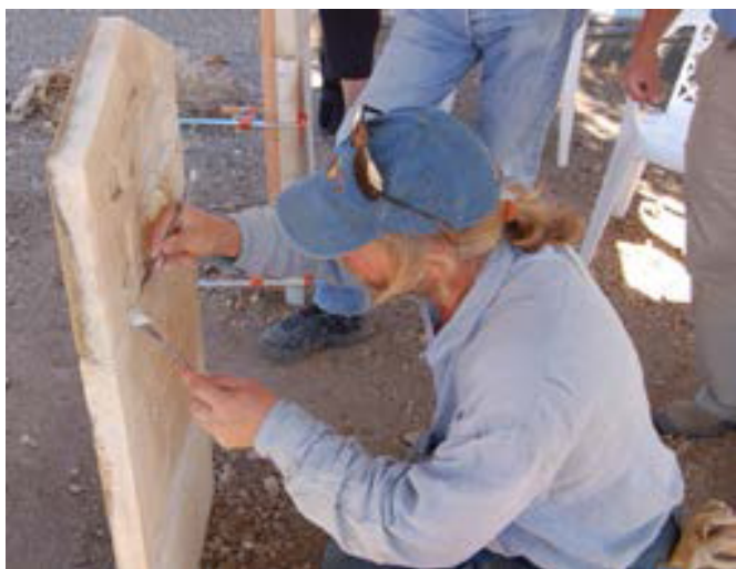
Figura 21. Las grietas en una lápida de piedra deben rellenarse para mantener el agua y la suciedad fuera del material, evitando que la grieta se agrande. Se debe diseñar un mortero de parcheo para ser utilizado con mármol histórico, en este caso. Foto: Mary Striegel.
