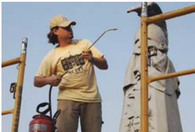
Figura 24. Un monumento o lápida gravemente deteriorado puede tratarse con un consolidante de piedra. El tratamiento se suele aplicar mediante un sistema de pulverización. El consolidante penetra en la piedra y reemplaza a los aglutinantes (binders) minerales que mantienen la piedra unida. Las pruebas y evaluaciones in situ y de laboratorio se realizan antes de utilizar este tipo de tratamiento que no es reversible. Foto: Lucas Flickinger.
