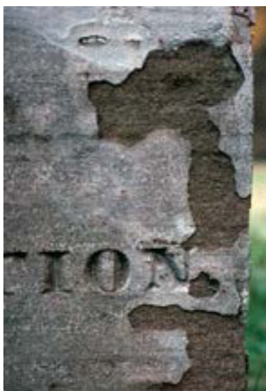
Figura 13. El revestimiento impermeable utilizado para “proteger” esta lápida de piedra arenisca atrapó la humedad dentro de la piedra, lo que eventualmente resultó en deterioro y pérdida de superficie. Foto: Fran Gale.
