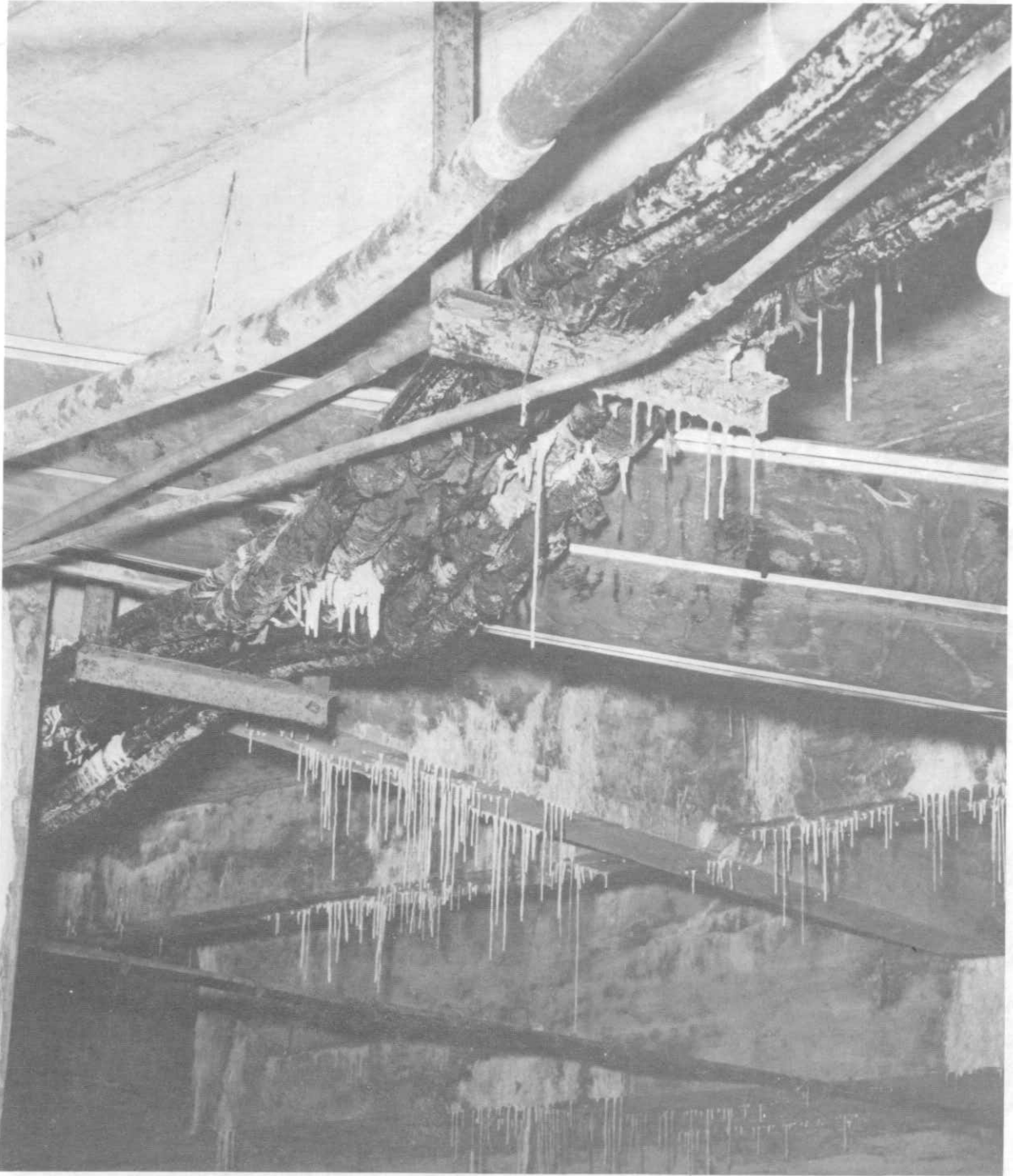
9b. BASEMENT CABLE See 9a.
