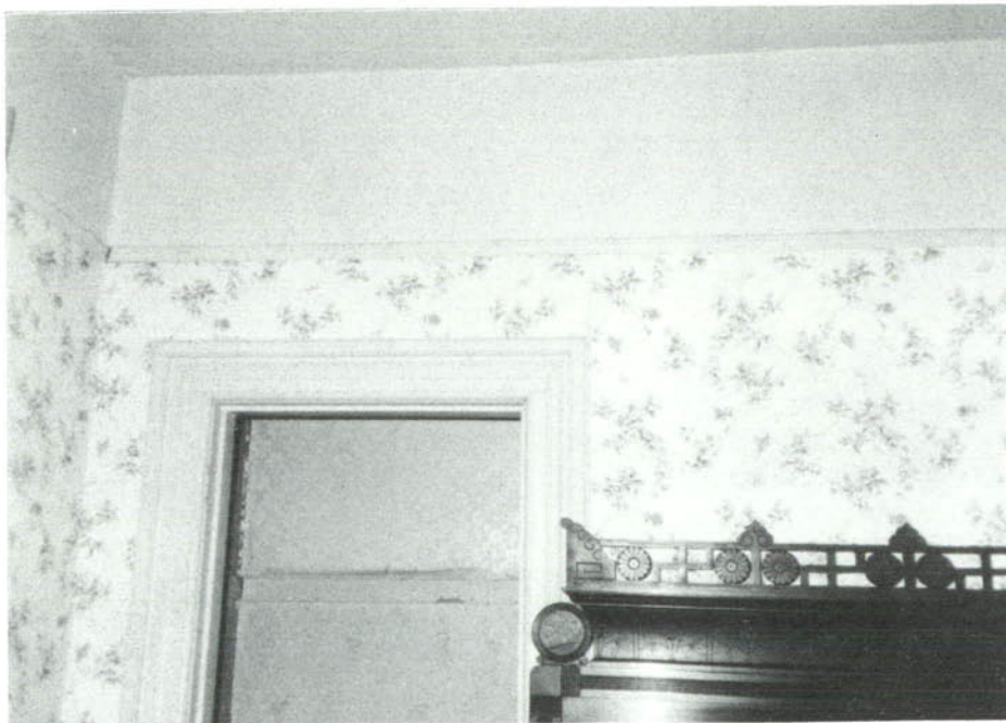
SP-14, Door displacement, rooms 203-204.
